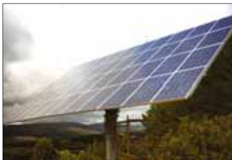
Seguidor solar en la casa rural Dharma Gaia, Galicia. Iniciativa financiada por Triodos Bank.
