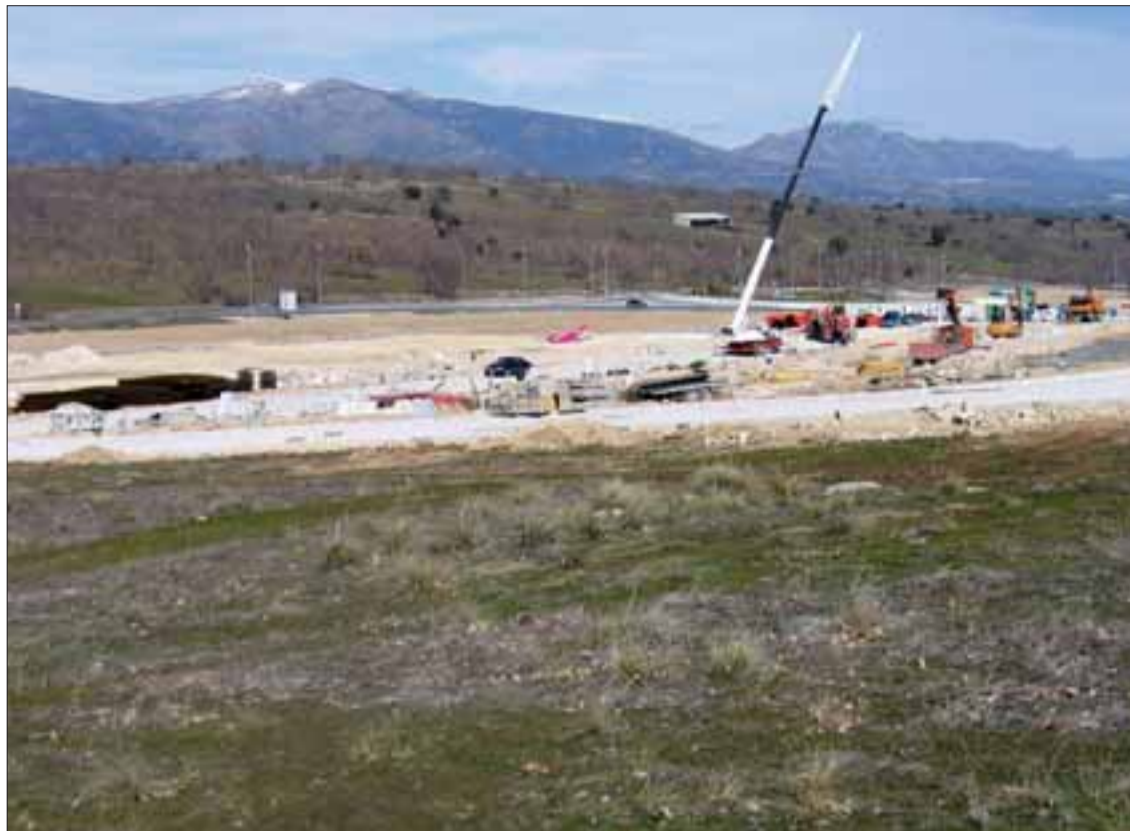
Urbanización Los Pinarejos (Miraflores de la Sierra), donde se construirán 700 viviendas, campo de golf y un centro comercial
