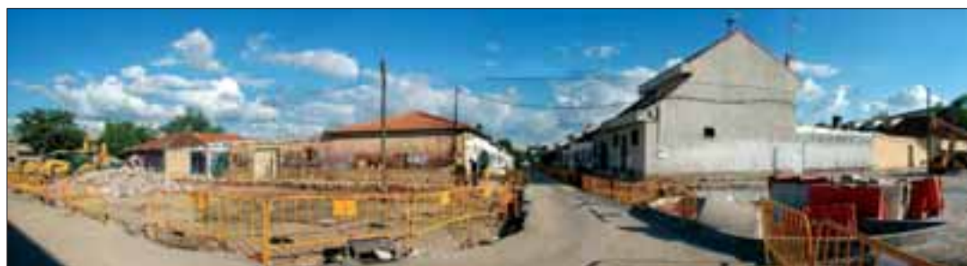
Calle Aluminio de la barriada de Zapatería el 9 de mayo de 2008 (arriba) y el 27 de mayo de 2008 (abajo)
